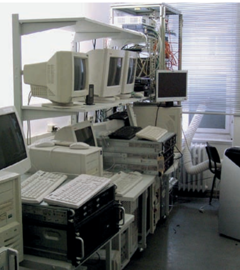
Der alte Serverraum ...
